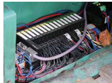
Systém Cube20S v rozváděči v kabině řidiče
